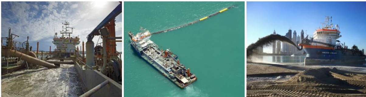
Figura 7-27 Descarga a través de compuertas inferiores, tubería flotante y arco iris
